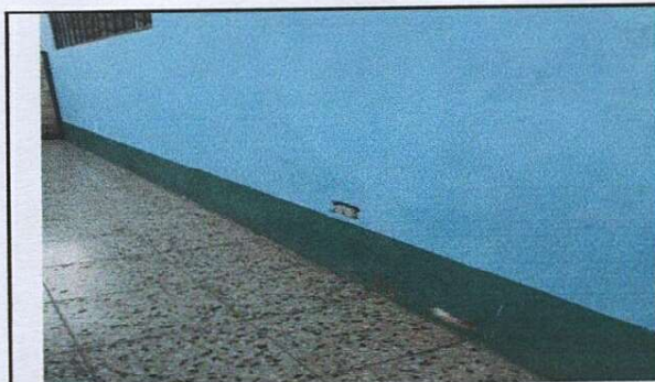
Foto 4: SUSTITUCION DE PISO DE GRANITO EN MAL ESTADO
