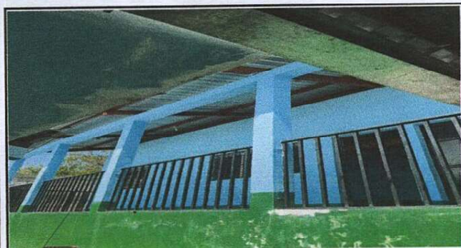
Foto 3: PAREDES EN MAL ESTADO, REPELLO DESBORONANDOSE EN AREAS DEL ESTABLECIMIENTO
